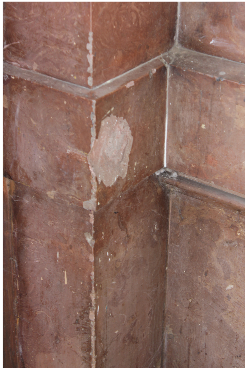
4. Mechanická poškození nárožních hran obkladu soklu ve vstupním vestibulu
