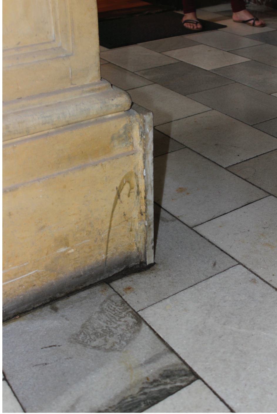
20. Nepůvodní obklad patky stylobatu přesahující přes hranu původního prvku
