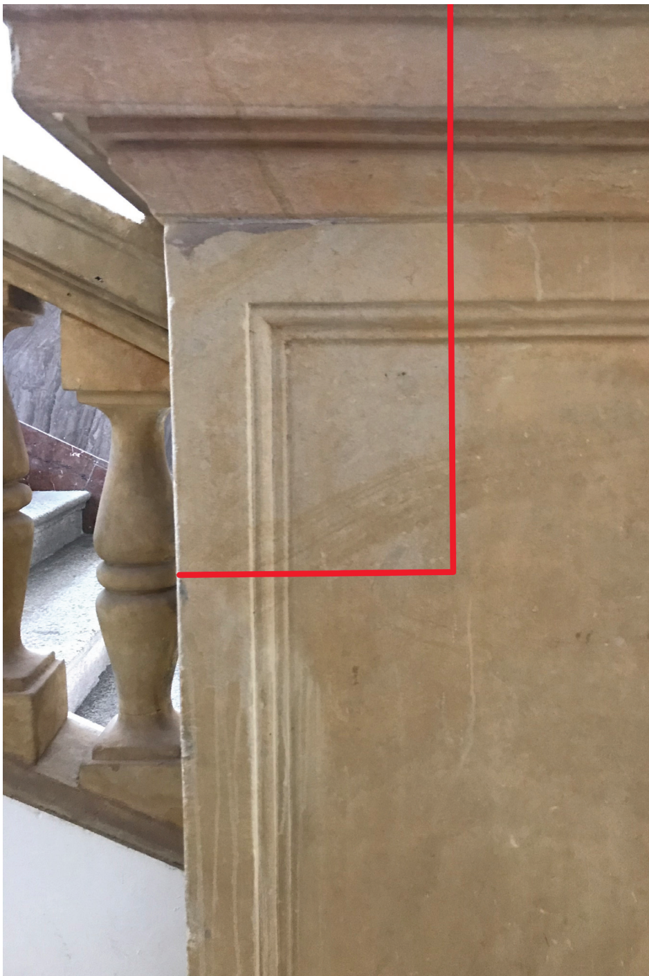
23. Zkouška čištění povrchu pískovcového prvku teplou vodní párou, vlevo očištěná část (odstranění okrového sjednocujícího nátěru)
