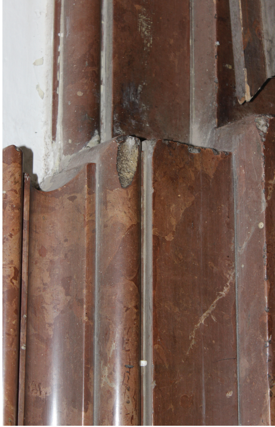
5. Profilace soklové římsy, mechanická poškození
