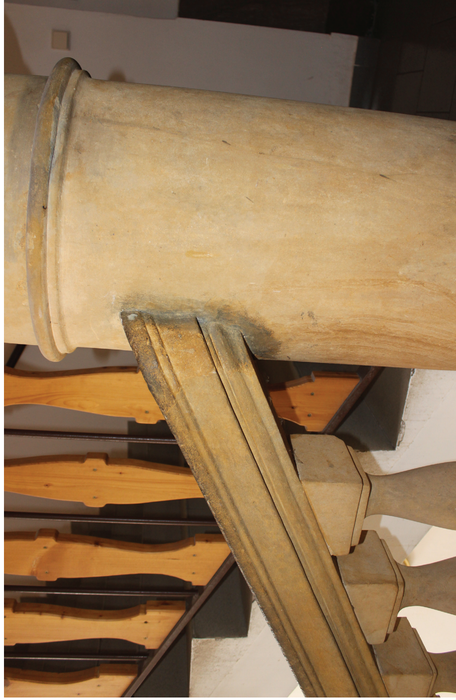
19. Detail navázání madla na sloup v 2 NP, starší oprava
