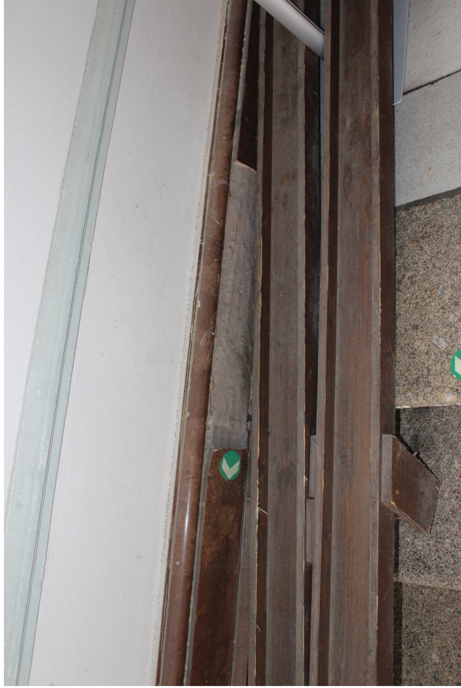
6. Levá strana vstupního vestibulu směrem od vchodu, zcela chybějící část pásu umělého mramoru taženého přímo na stěně
