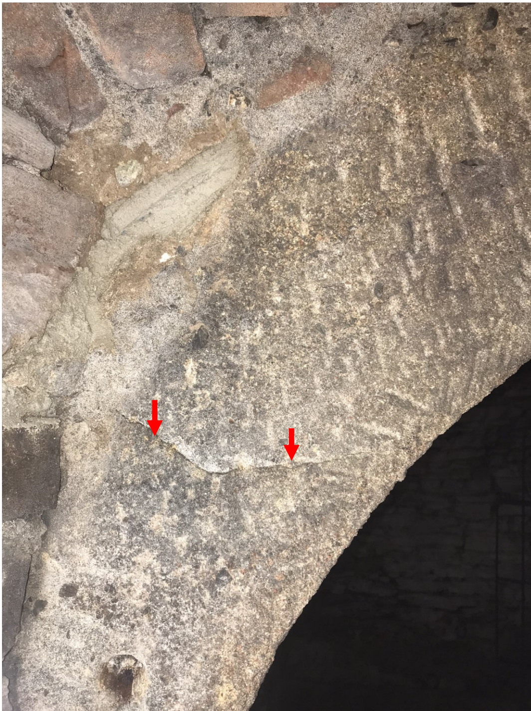
3. Trhlina ve hmotě náběhu záklenku nadpraží vzniklá působením tlaku klenby, pohled na stranu portálu směřující do chodby k dalšímu rameni schodiště
