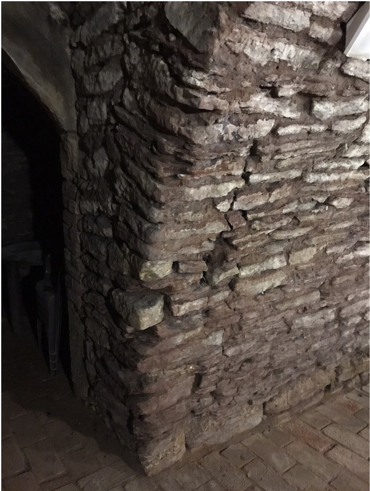
5. Příklad poškozeného nároží svislé stěny v důsledku tlaku klenby
