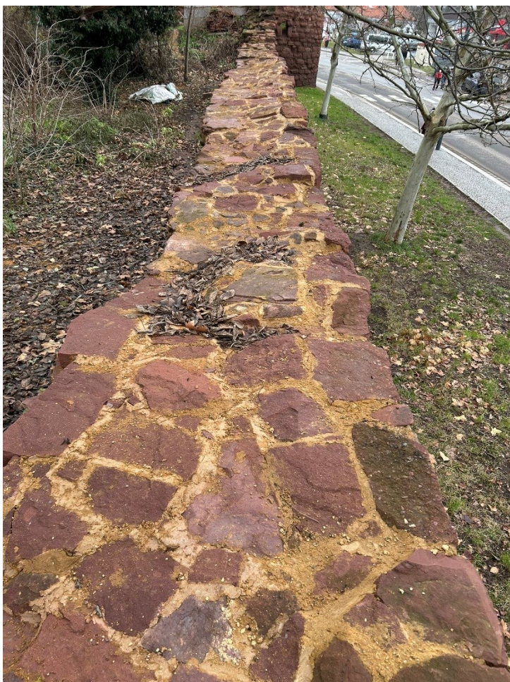
5. J kurtina, prohlubně ve svrchní ploše koruny zdiva, nefunkční spádování
