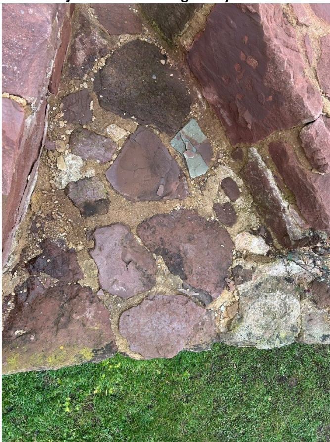
3. Poškození malty spár v ploše střilny z důvodu vyšší expozice vůči srážkové vodě
