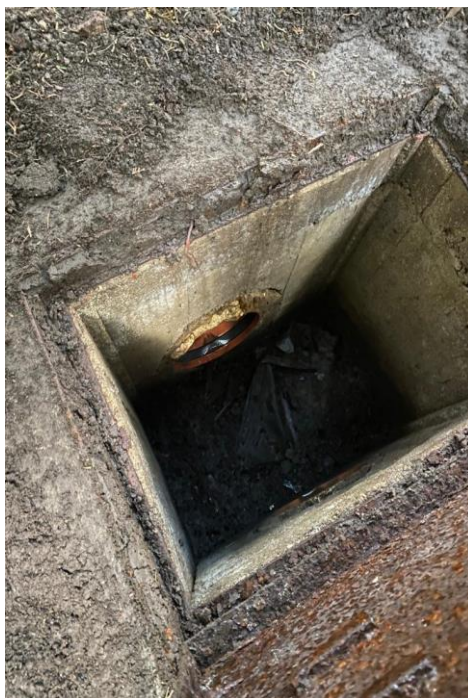
Obrázek 1 První revizní šachta
