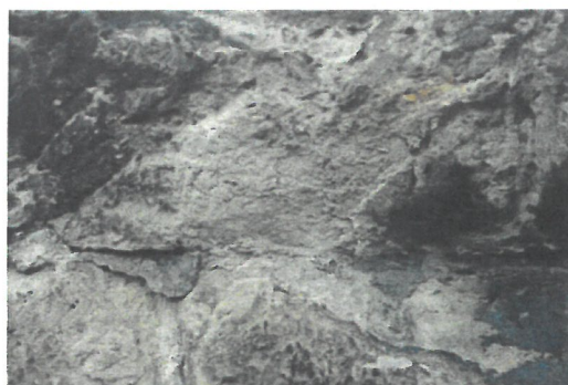
obr. 6 hloubková koroze kamene
