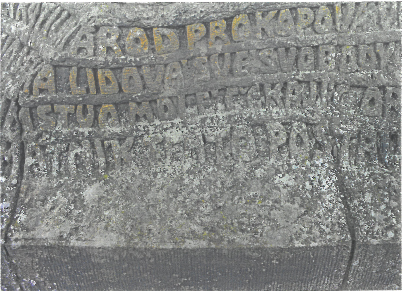
13. Biologické napadení povrchu kamene řasami a lišejníky, blok PA/3
