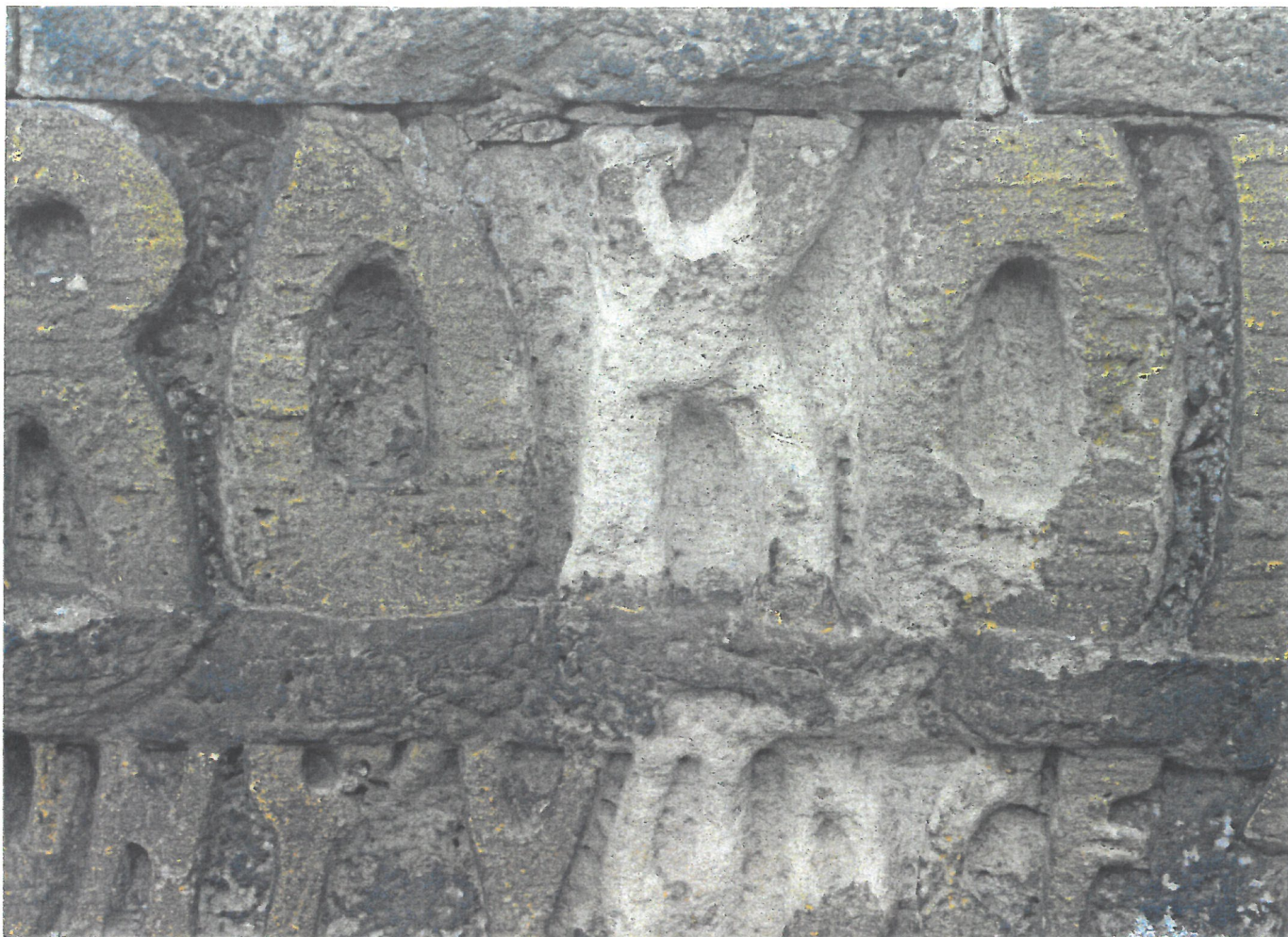
7. Detail hloubkové koroze, poškození nápisu, JV strana, blok PC/1
