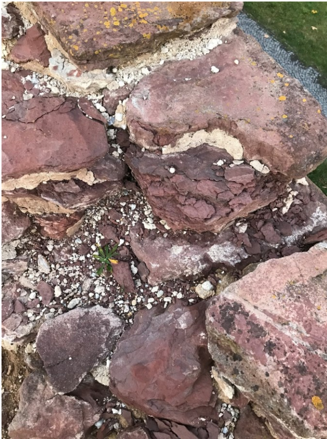
Foto 2/ Destrukce malty spárování a přilehlých kamenných bloků
