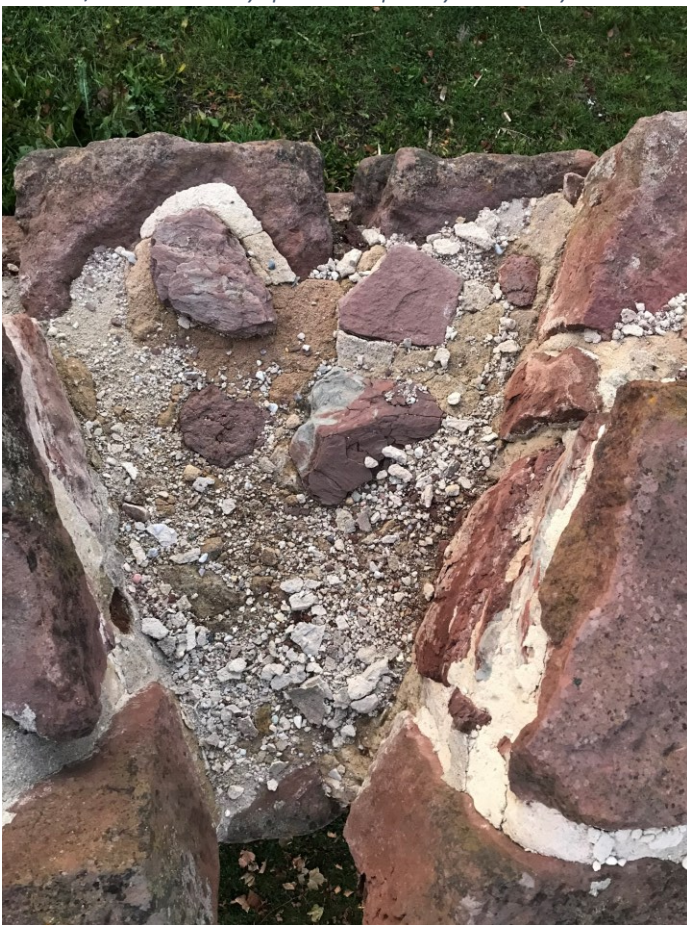
Foto 3/ Hlubková destrukce malt parapetu nálevkovitého typu střílny severně od nárožního bastionu
