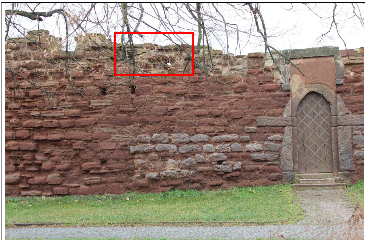
Český Brod, torzo fortifikace města, V kurtina, lícová strana zdiva fotodokumentace stavu
