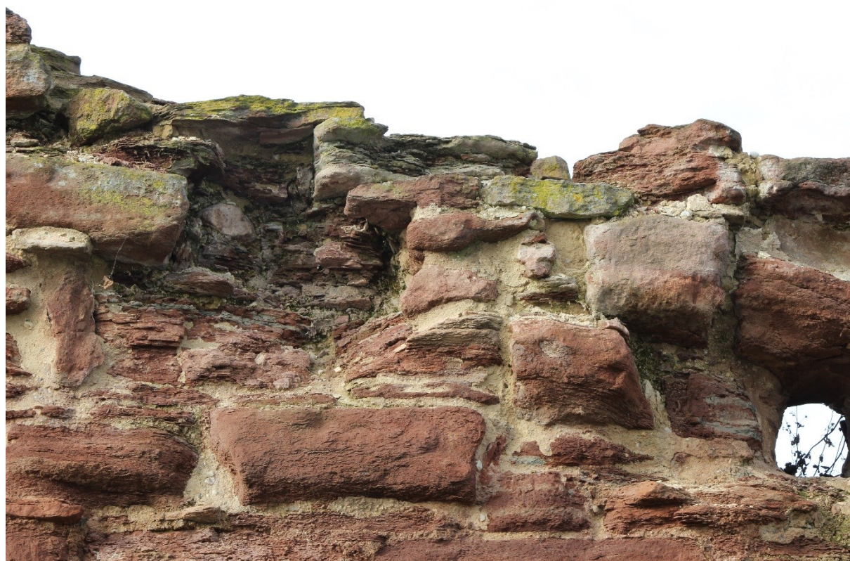
Kaverna vzniklá rozpadem kamenného bloku
