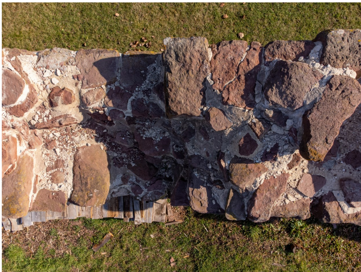
Detail poškození spárování, parapetní střílna
