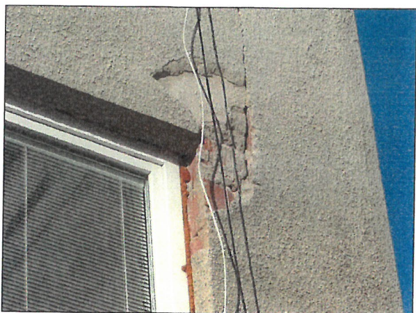
č. 22 Pavilon E, východ, detail poškození zdiva
