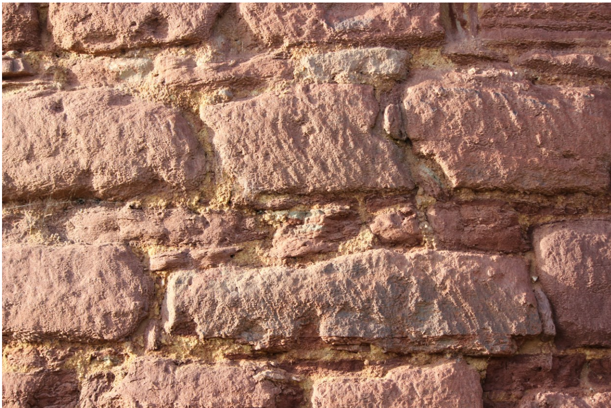
1. Příklad skladby zdiva, opracování líce kamenných bloků a vyplnění spár drobnějším materiálem jako vzor pro rekonstrukci /JV bašta/
