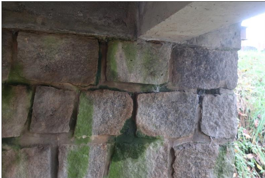
průsaky zdivem dříku levobřežní opěry O1
