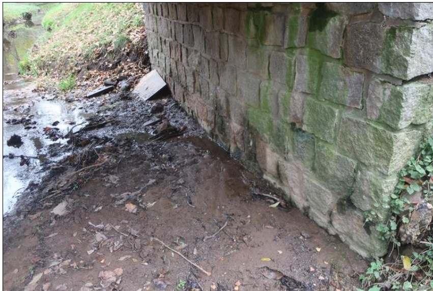
průsaky dřikem levobřežní opěry O1
