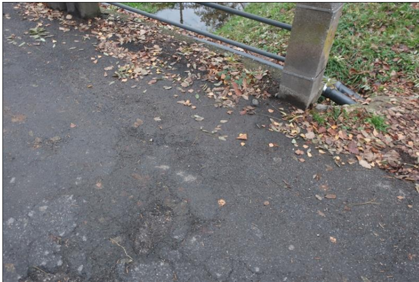
počínající výtluky v krytu vozovky
